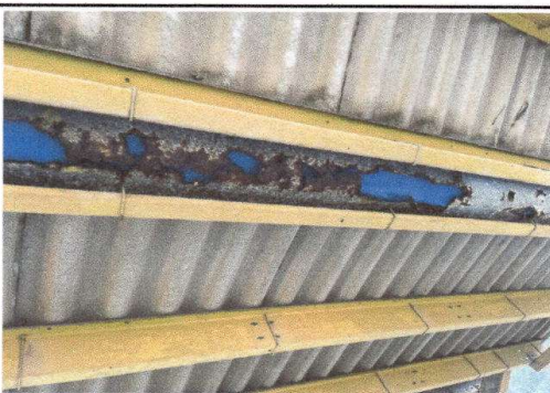
Foto 5: Sustrucción de canal de metal.
